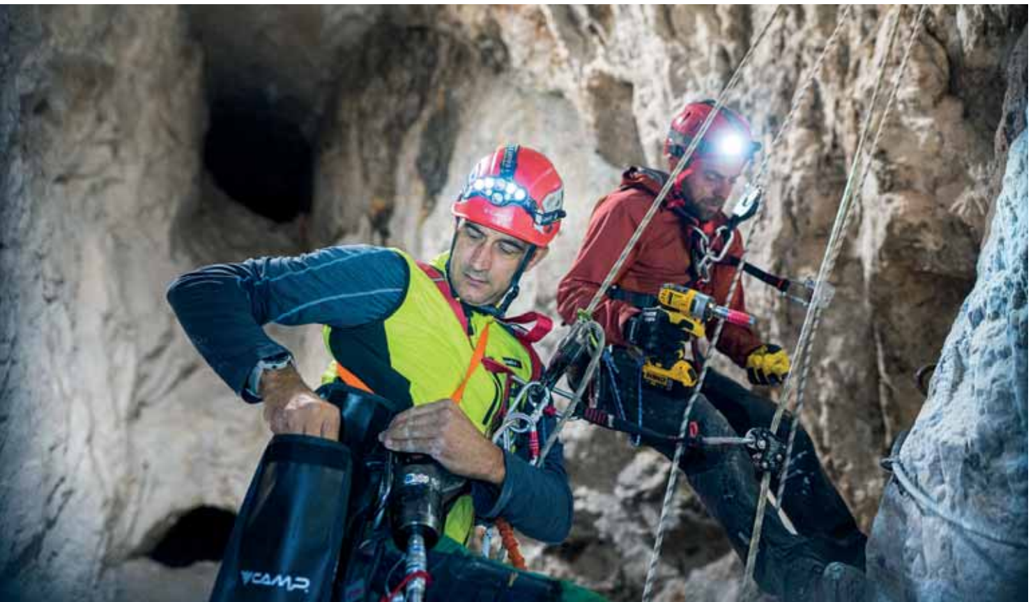
A sliver of light illuminates the work of Emilio Malugani and Andrea Cari in a barite mine. Juegos de luces y sombras durante los trabajos de seguridad en una mina de barita realizados por los técnicos Emilio Malugani y Andrea Cari Cortabbio, Italy (courtesy of Parco Minerario di Cortabbio and Emilio Malugani & C. snc, ph.Giovanni Danieli).
