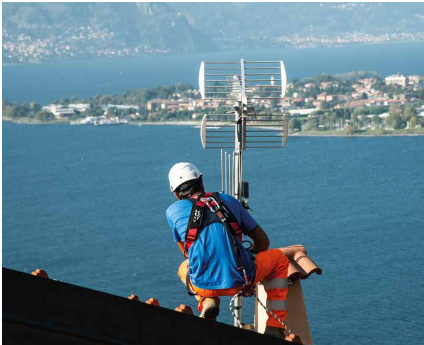
Installation of an antenna with the awesome view of Lake Como. Instalación de una antena con vistas excepcionales al Lago de Como. Bellano, Italy (ph. Riky Felderer, courtesy of Costruzioni Bertoldini srl, © C.A.M.P.).
