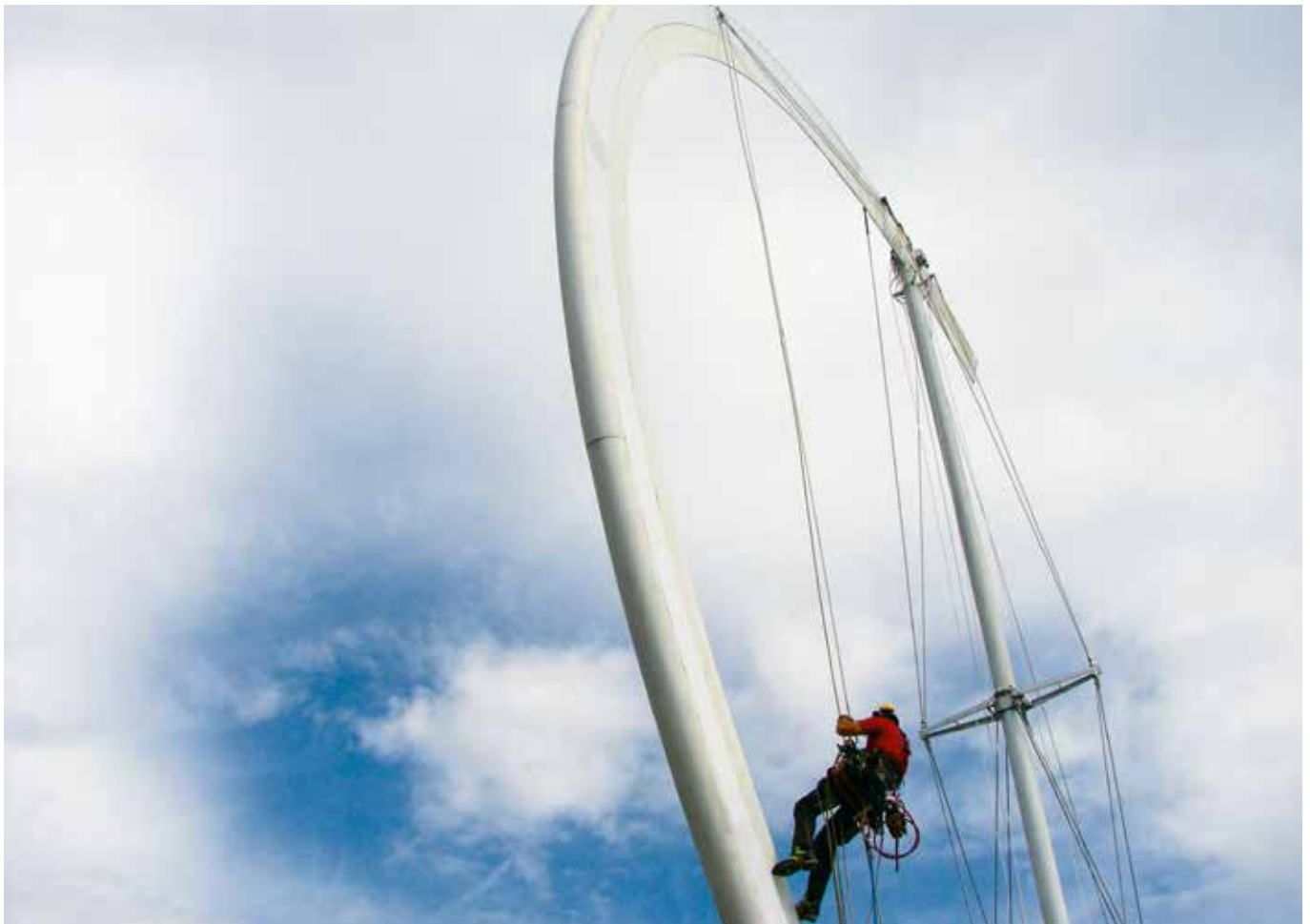
Rope access inspection on a civil engineering structure. Acceso por cuerda para la inspección de una estructura de ingeniería civil. Ouchy-Lausanne, Switzerland (courtesy of Corde-Access SA, © Corde-Access SA).
