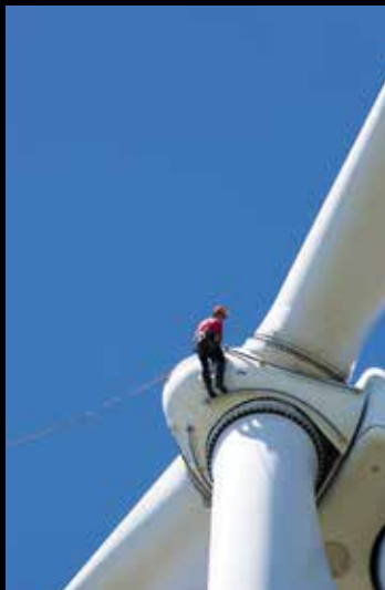
Turbine hub inspection at a wind farm. Inspección del rotor de una turbina en un parque eólico. Boulder, Colorado, USA (ph. Jack Perry, © C.A.M.P.).
