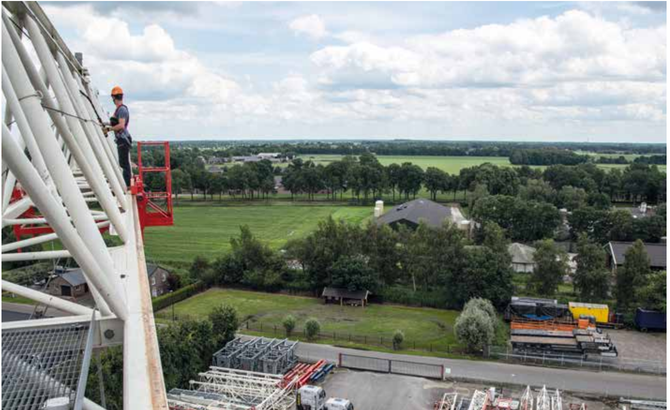
Inspection on a tower crane at Stravers Torenkranen factory. Inspección de una torre de grúa en la factoría Stravers Torenkranen. Veghel, The Netherlands (ph. Riky Felderer, courtesy of Heightinfra, © C.A.M.P.).
